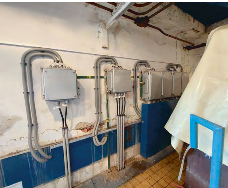
Obr. 2 Pohľad na nové rozvádzače ohrevu II. hafového poľa
